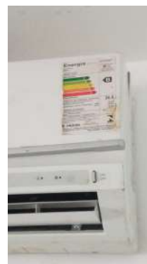
Imagem 4: Ar condicionado classe B
