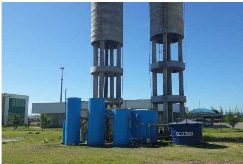
Imagem 1: Estação de Tratamento de Água da ZPE CEARÁ
